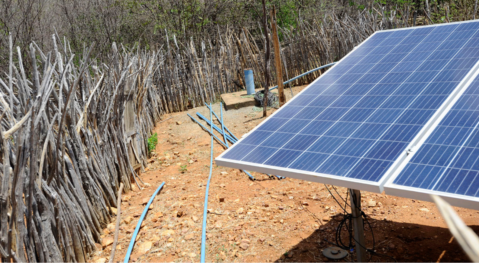
Solaranlage mit Pumpe
